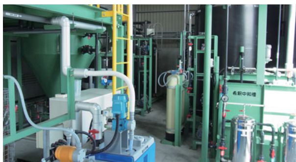
新神戸工場排水処理設備
